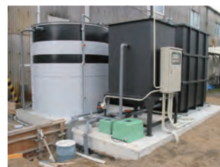
廃水処理設備
